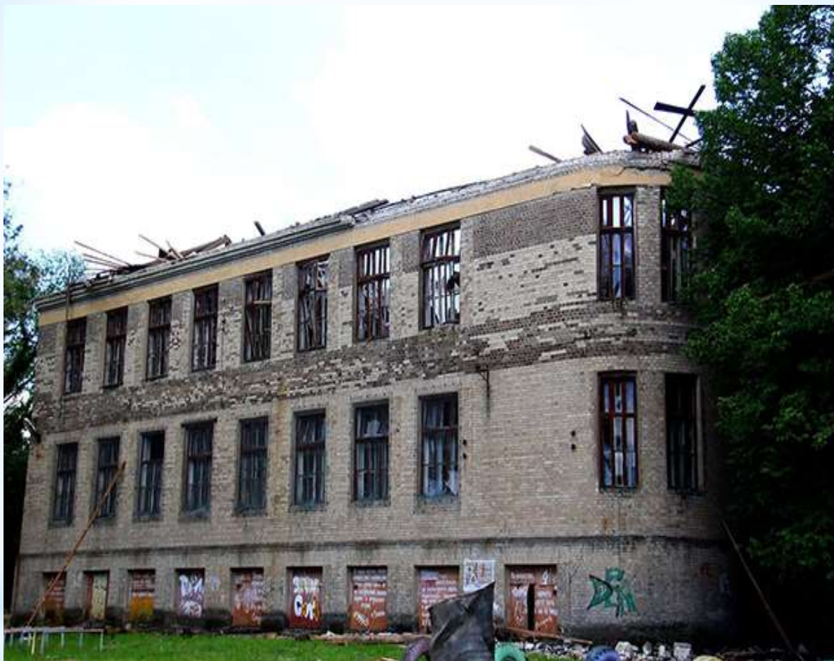
Зруйнована будівля Красногорівської ЗОШ №2
